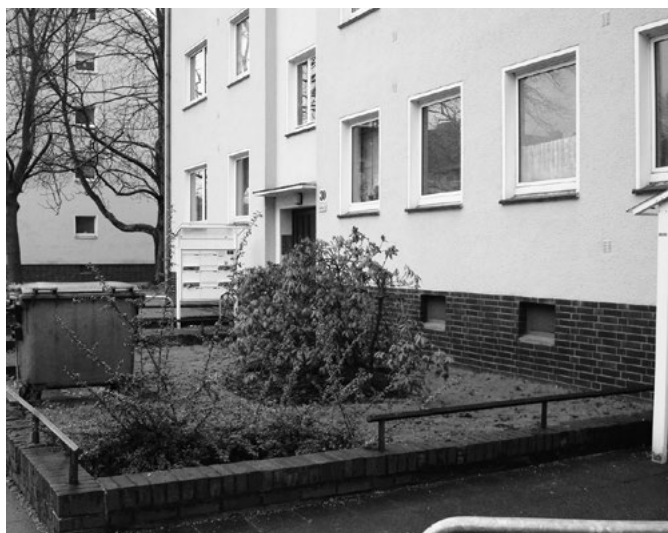
Vorher: In den Vorgärten standen die Müllcontainer offen herum, die Einfassungsmauern der Vorgärten waren marode, die Bepflanzung nicht mehr zeitgemäß und schwer zu pflegen.
